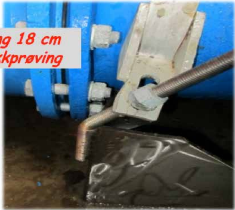
Figur 2. Store krefter virker i vannkummene (Foto: Arve Hansen, VA-teknikk as).
