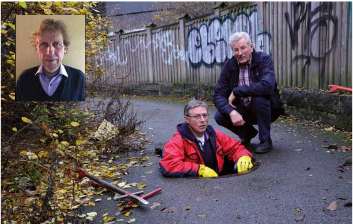
På vegne av Rørinspeksjon – Norge har VA-senioren i Drammen kommune, Yngvar Heimstad (t.h) og Arve Hansen i VA teknikk AS i Drammen (t.v), sammen med rådgiver Tom A. Karlsen i Cowi (innfelt), hatt ansvaret for rapportering og koordinering av arbeidet med rapport om kumsikkerhet.
